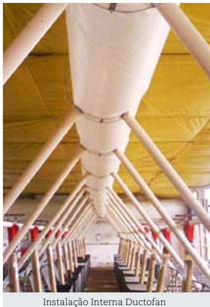
Instalação Interna Ductofan
